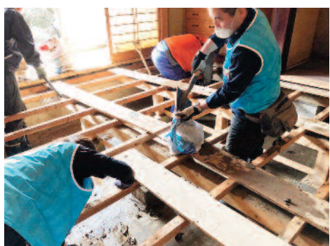
床下の泥かきは重労働（栃木市）
